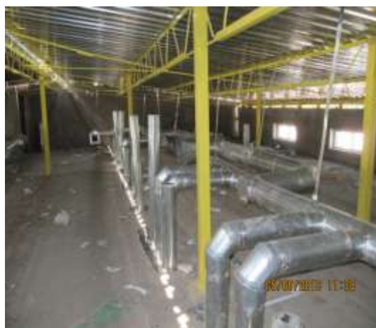
Система воздуховодов вентиляции
